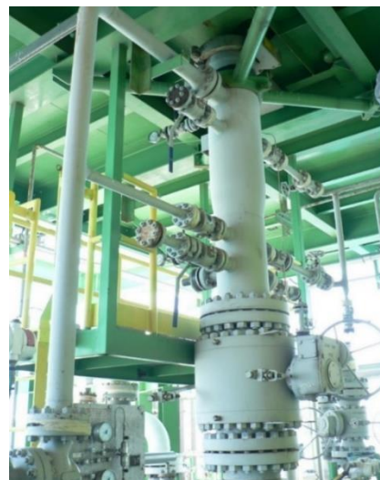
Фиг. 3.7. Изображение на пускова камера, използвана за инспекция на газопровода
